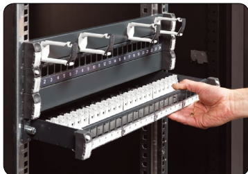
8. Patchpanelet trækkes ud til stoppet og der kan nu monteres konnektorer og kabler.
